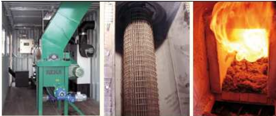
Abb.46: Heuverbrennungsanlage in Sonnenbühl mit dem Cutter zum Zerkleinern der Ballen (links), einem speziellen Edelstahlfilter zur Verminderung der Staubemissionen (Mitte) und dem Brennraum (rechts) (QUELLE: DEUTSCHER VERBAND FÜR LANDSCHAFTSPFLEGE E.V., 2008).
